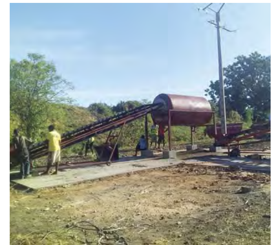
Equipements de mécanisation installés au niveau du CTE. Photo : Gescod
