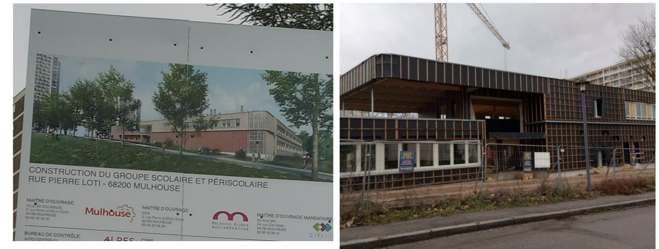
LE CHANTIER DU GROUPE SCOLAIRE SIMONE VEIL, RUE PIERRE LOTI (SOURCE : EGIS, FÉVRIER 2024)
