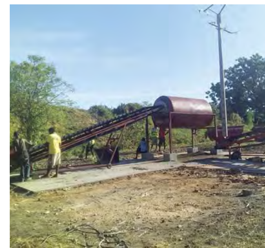
Equipements de mécanisation installés au niveau du CTE. Photo : Gescod
