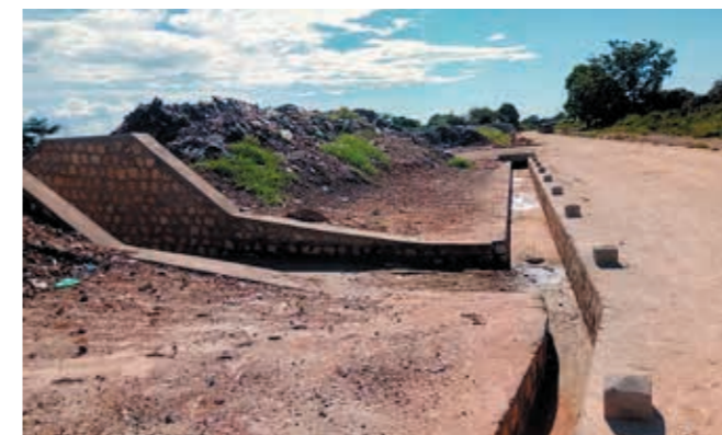
Canal d'assainement de l'annexe du CTE
