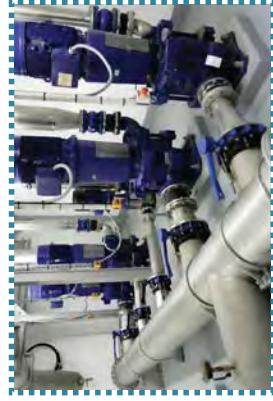
Station de surpression du Parc des Collines
