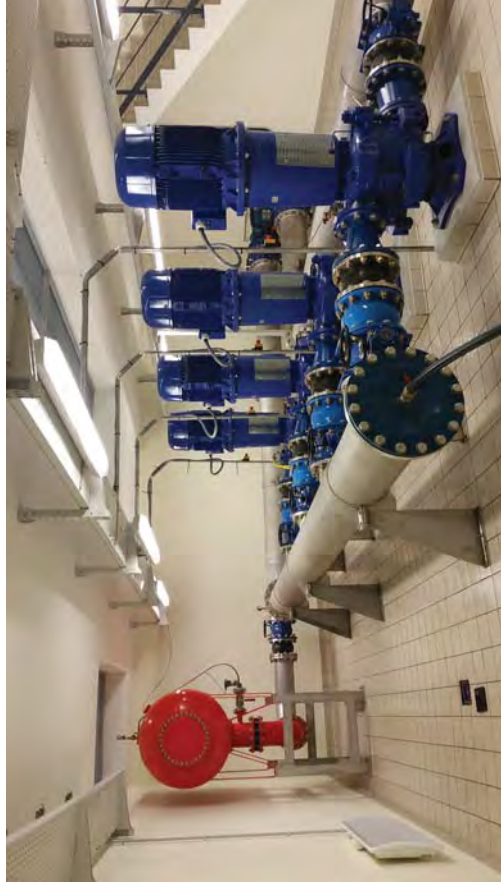
Station rue de Verdun à Rixheim
