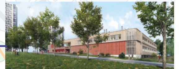
Le groupe scolaire Simone Veil, rue Pierre Loti, en cours de construction. Réalisation : 2022-2024
